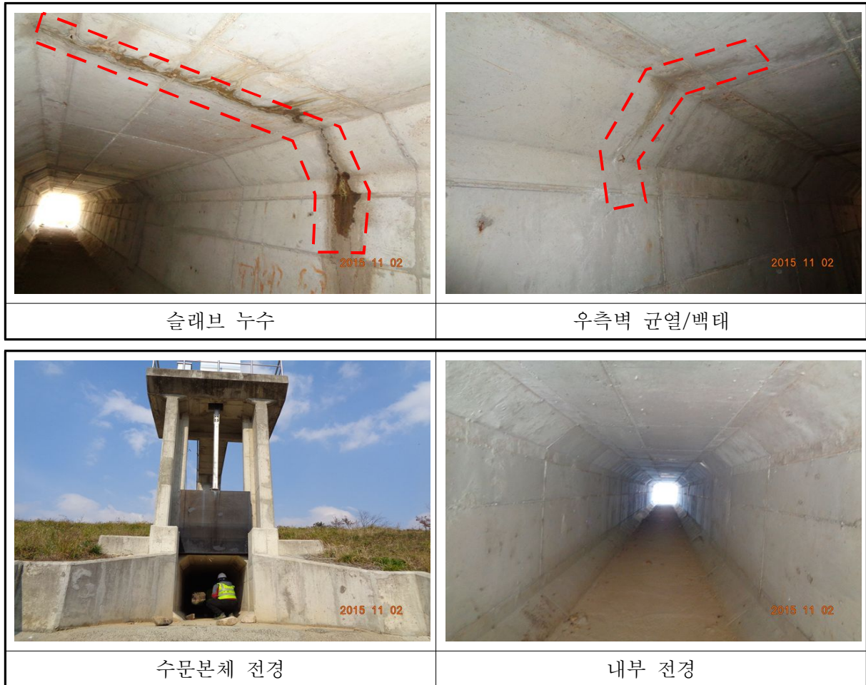
【사진 Ⅱ.3-1】 수문구조물 손상현황
